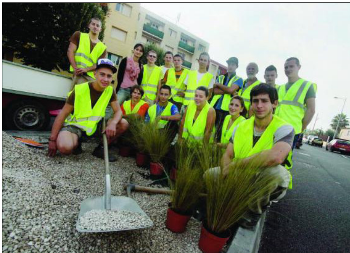
Les apprentis et stagiaires sur le chantier lors de leur intervention. Cette réalisation fait partie de leur formation. Une opération gratifiante pour eux car elle est réalisée sur la voie publique. Bientôt, les Antibois pourront profiter de leur savoir-faire.
